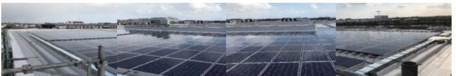
太陽光パネル
